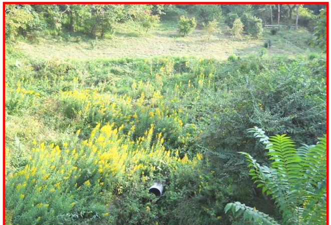
草茫々の暗渠周り。
