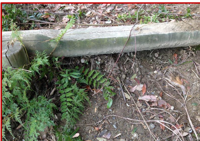
遊歩道の階段も、土が流れて浮き上がっていて危険です。
