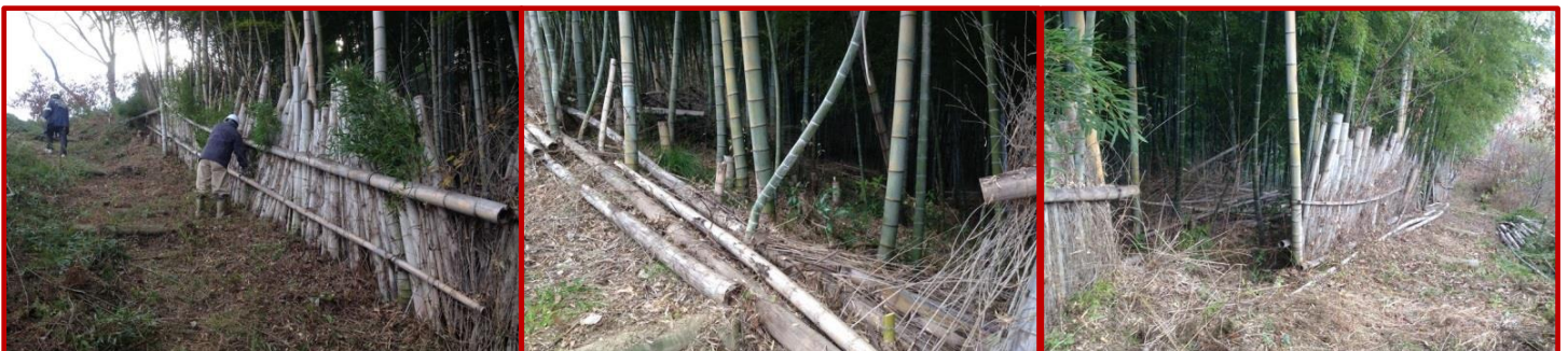
竹柵は、まだしっかりした部分もありますが、柱の竹が腐ったため壊れた部分があり、補修が必要です。
