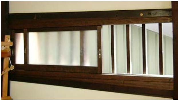
安政大地震で傾いた窓枠と修理した水平の窓
