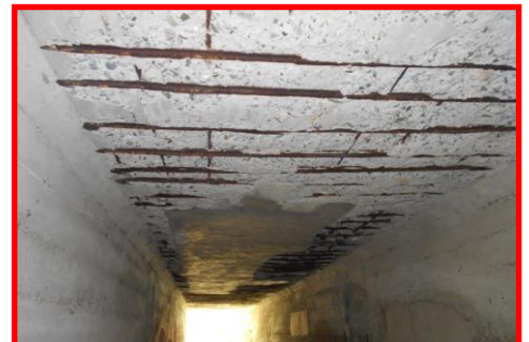
崩落している暗渠の天井。
